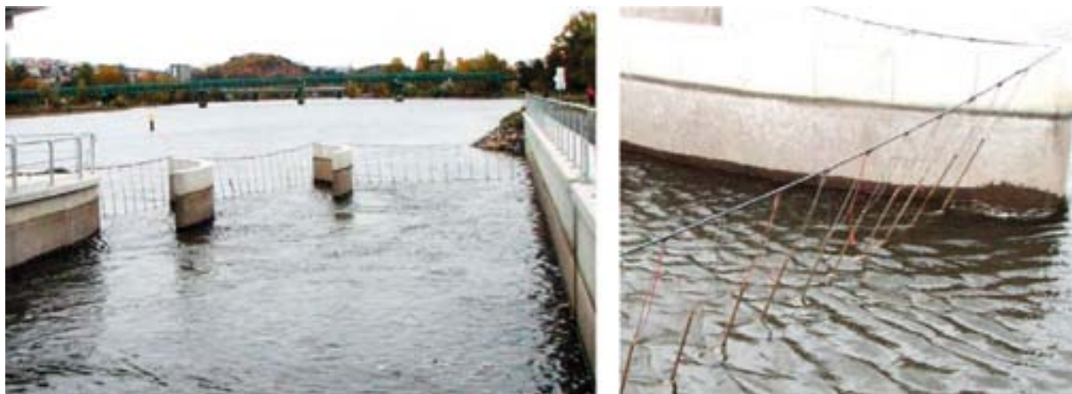
Obr. 11.4 Pohled na zavěšené elektrody v nátoku MVE Troja
