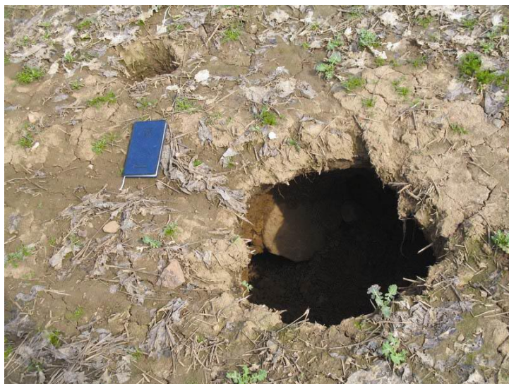
Obr.1 Kaverna, způsobená vnitřní erozí půdy v místě drénu a následným vyplavením půdních částic. Okres Jičín. Foto M. Soukup
