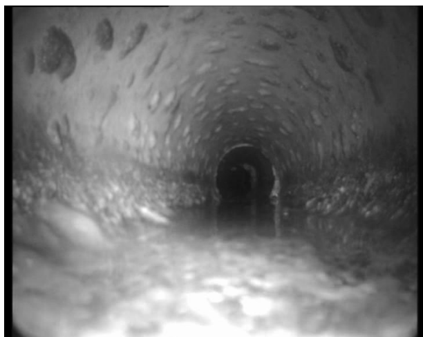
Inkrustace na potrubí z pálené hlíny
