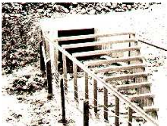
Obr. 5.6.1.4 Deflektor spláví před propustkem. Ocelová konstrukce má funkci hrubých česli, zešikmení snižuje šanci na ucpání česlí vytlačáním dřevní hmoty do horní části a zachování spodní části profilu pro průtok.
