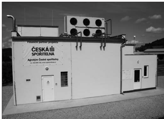
Foto 5: Budova kogenerační jednotky – zemědělská BPS Krásná Hora n. Vlt.
