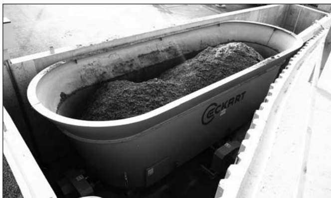
Foto 1: Zásobník dávkovače substrátů – zemědělská BPS Chotýčany
