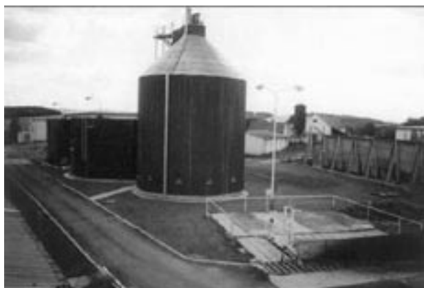
Obr. 5: Zemědělská bioplynová stanice Trhový Štěpánov
