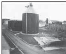
Foto 1: Zemědělská bioplynová stanice Trhový Štěpánov
