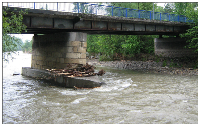
Obr. 4: Fotografie podemletého pilíře v toku řeky Ostravice
