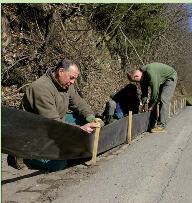
▲ Instalace zábran, které u silnic zachraňují migrující žáby.
